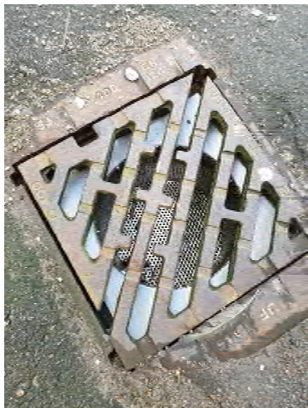
Figur 3: Exempel på miljöskyddsåtgärd; dagvattenbrunn med finperforerad metallinsats som täpps igen vid eventuellt bitumenspill och därmed förhindrar vidare utsläpp.
