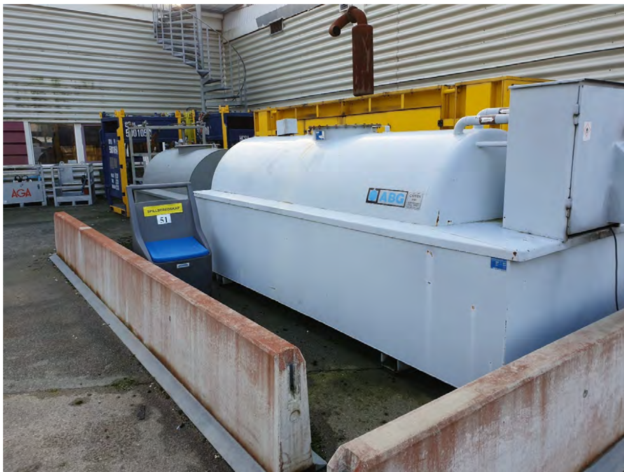
Figur 6: Tankplats för dieseltruckar (inklusive påkörningsskydd, spillberedskap och mantlad tank)
