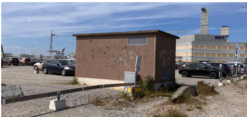
Bild 28. Befintlig nätstation norr om Verkövägen i området vid Rombvägen.
