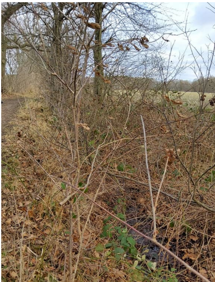
Figur 9: Befintligt grunt och igenväxt dike.
