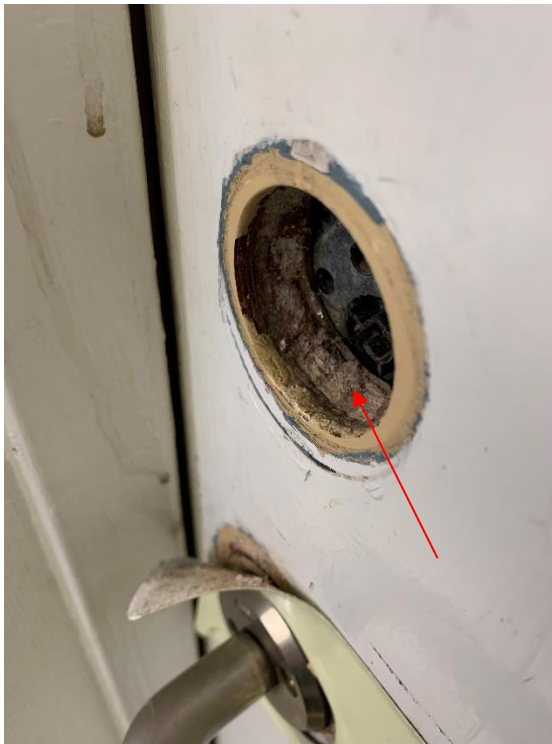
Foto 9. Asbestisolering i äldre branddörrar (fabrikat Hellberg från 1965), här blottad isolering.
