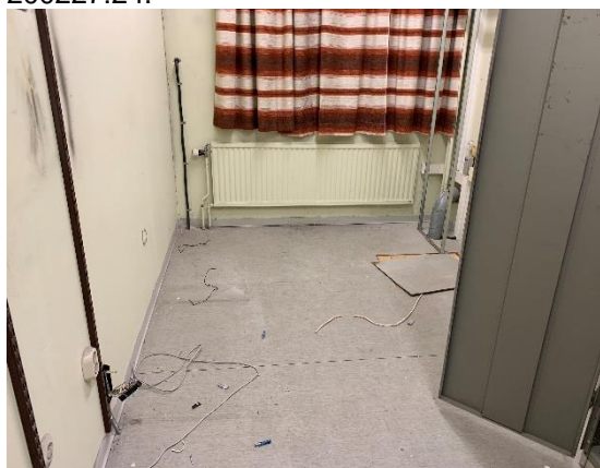
Foto 4. Grå golvmatta innehåller asbest, verifierat via prov 200227:8
