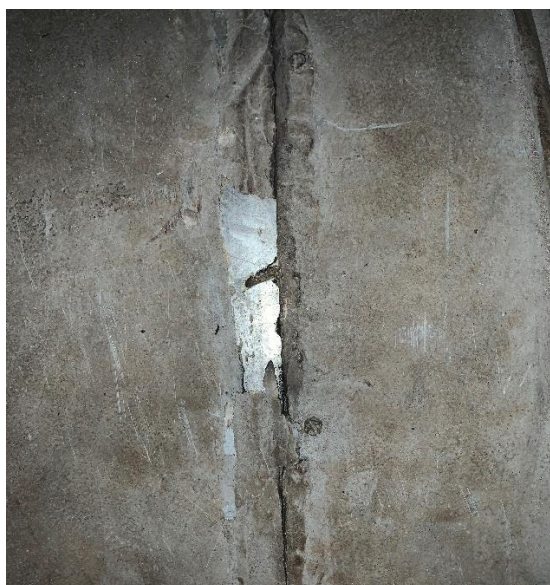
Foto 2. Asbest har verifierats i tätningsskitt på ventilationskanaler via prov 200227:4 och 200227:24.
