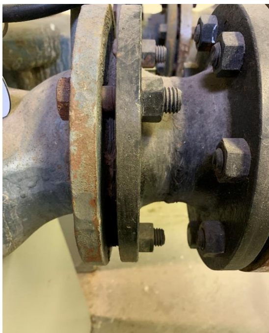
Foto 5. Packning innehåller asbest, verifierat via prov 200227:10.
