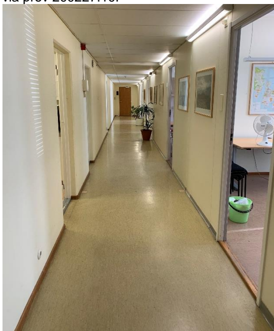
Foto 7. Grå/grön golvmatta innehåller asbest, verifierat via 200227:14. Förekommer generellt.
