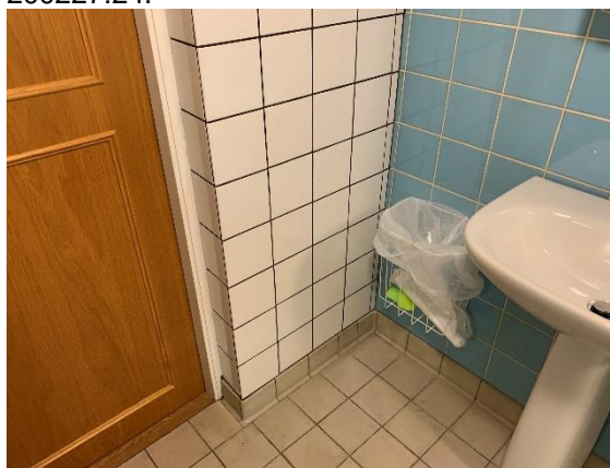
Foto 3. Asbest har verifierats i klinkerfix-och fog via prov 200227:6. Kakelfix- och fog innehåller inte asbest, verifierat via prov 200227:5 och 200227:19.
