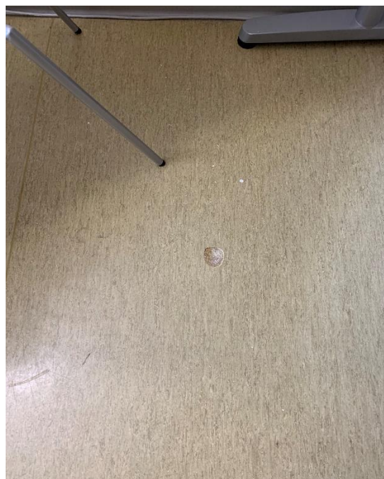
Foto 6. Grå/grön golvmatta innehåller asbest, verifierat via 200227:14.
