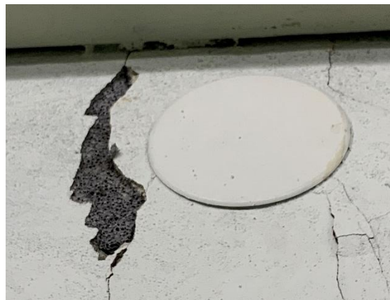
Foto 16. Blå lättbetong förekommer i konstruktion.
