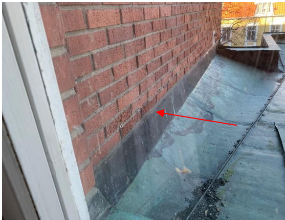
Foto 25. Fog mellan tegel och plåt innehåller inte PCB eller klorparaffiner, verifierat via prov 200227:21
