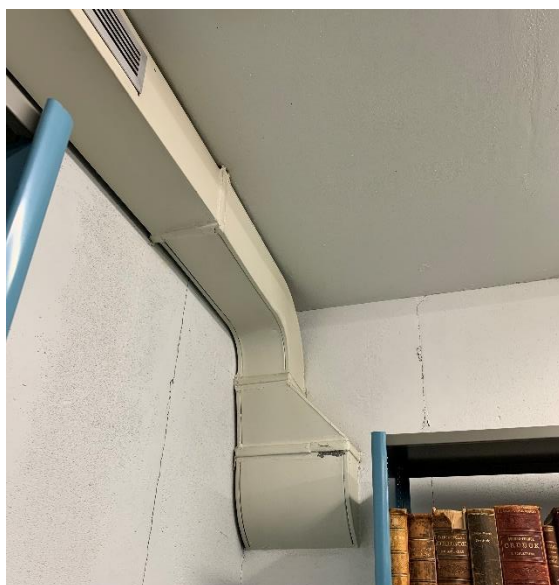
Foto 1. Asbest har verifierats i tätningsskitt på ventilationskanaler via prov 200227:4 och 200227:24.
