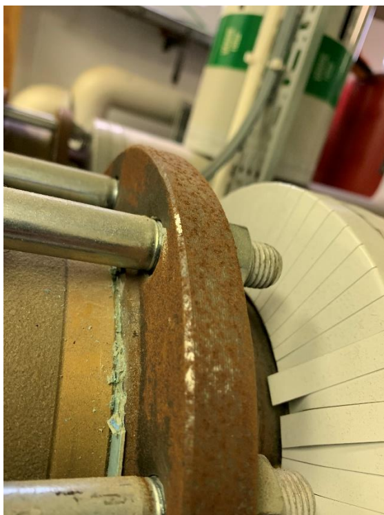
Foto 21. Blå packning innehåller inte asbest, verifierat via prov 200227:11.
