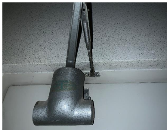
Foto 14. Äldre dörrstängare ( Anchorverken ) misstänks innehålla PCB-olja.
