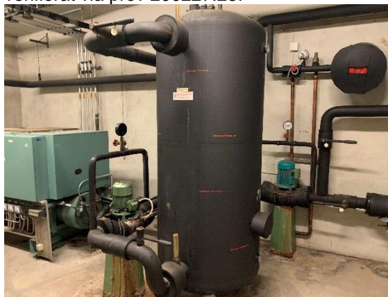
Foto 15. Bromerade flamsskyddsmedel i cellgummiisolering av typ Armaflex förekommer.
