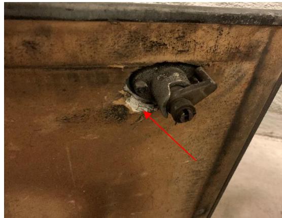
Foto 26. Isolering i fläktlucka innehåller inte asbest, verifierat via prov 200227:22.
