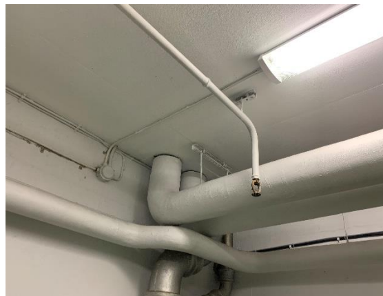
Foto 12. Isolering i rörböjar/förgreningar samt avslut innehåller asbest (okulär bedömning).
