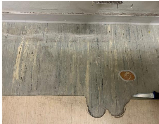
Foto 17. Äldre golvmatta (under nyare golvmatta) innehåller inte asbest, verifierat via prov 200227:1.
