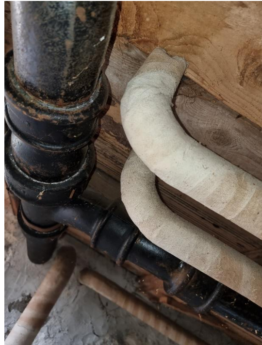
Figur 24 rörkrök med förmodad asbest
