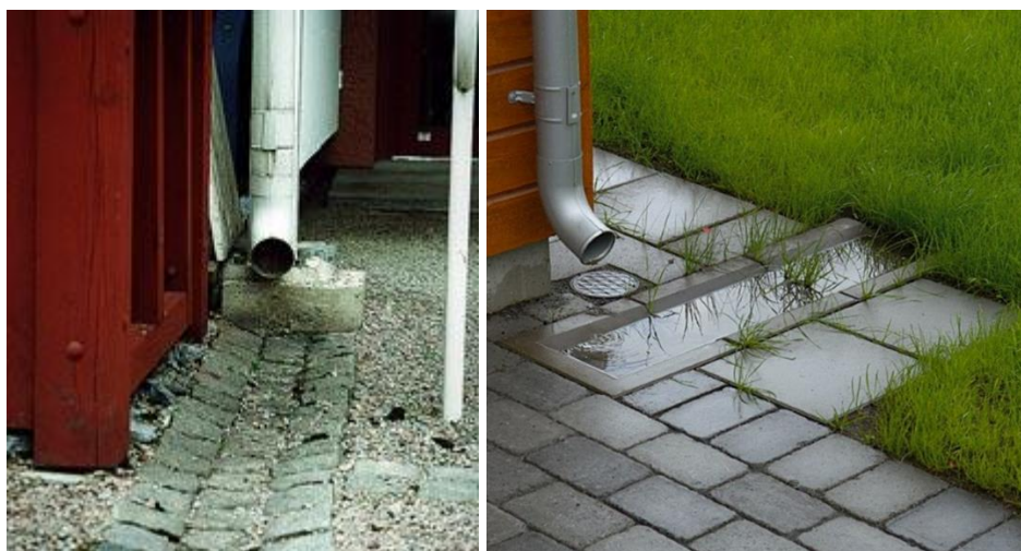
Figur 13: Exempel på ytliga dagvattenrännor 1112
