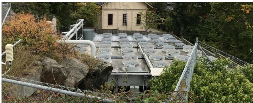
Figur 3. Fjärrkyleanläggningen i Gräsvik
