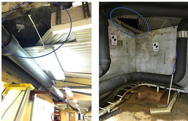
Figur 3 Delar av innertaket har lossnat vilket gör det möjligt att se berget ovanför.
