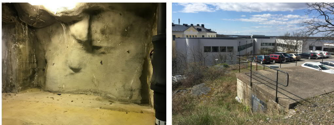
Figur 4 Vänster bild visar vita kalcitutfällningar vid entrén. Höger bild visar läget för ventilationsschaktet (betongplattan) på markytan.
