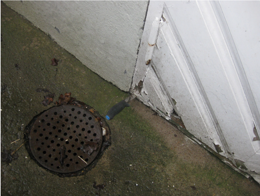
Rötskadad ytterdörr källaringång på norra gaveln
