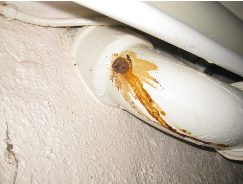
Skadat avloppsrör i källaren
