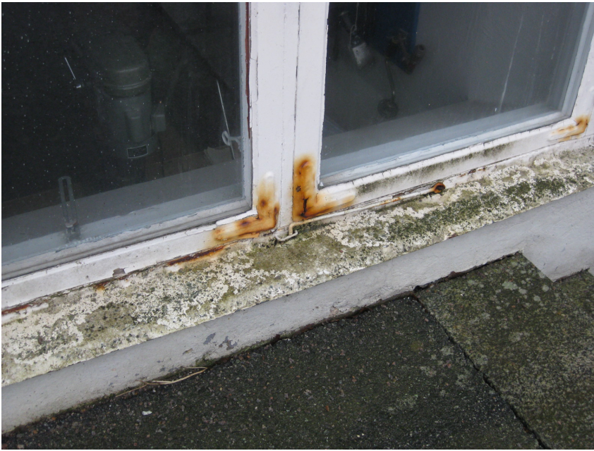
Rostskadade hörnbeslag på källarfönster
