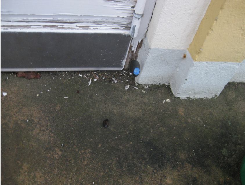
Rötskador i karmsidostycke ytterdörr östra fasaden
