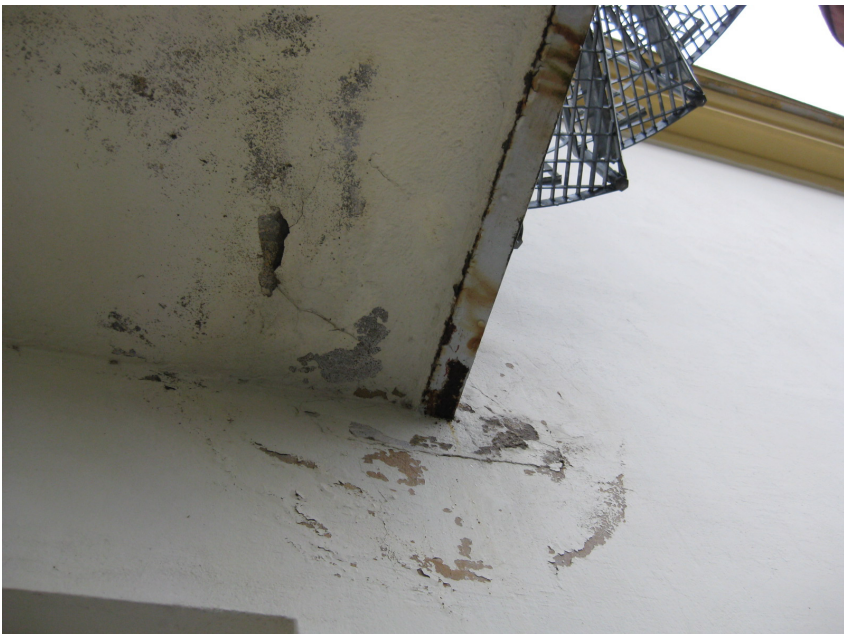
Skadad balkong på den norra gaveln
