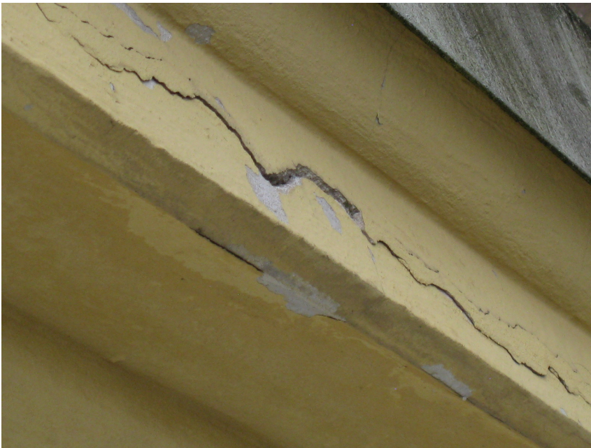
Skada hos takfotslist på norra gaveln
