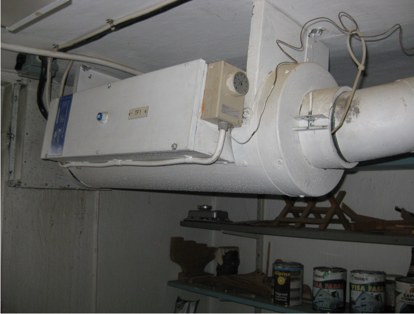
Kanalaggregat i 1021 (risk för innehåll av asbest)
