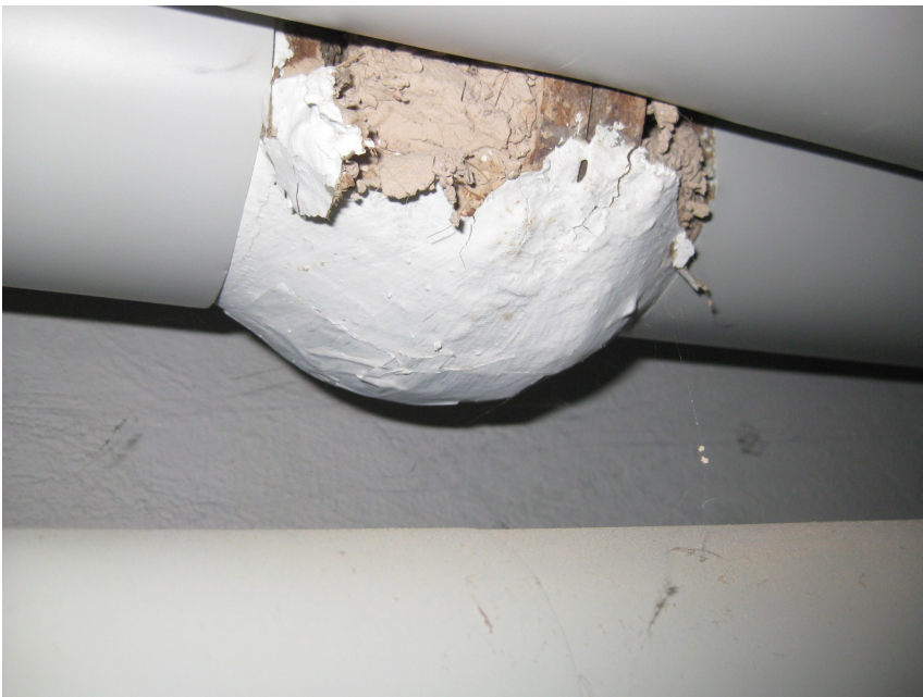
Fri asbest hos rörböj
