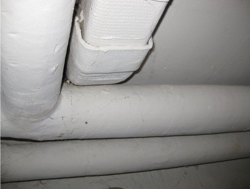
Eternitkanal innehållande asbest
