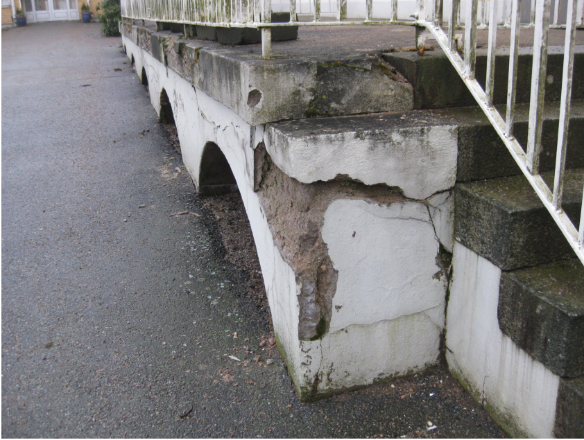
Dålig betongbalkong östra fasaden
