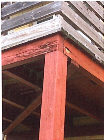
Balkongkonstruktionen bör säkerhets besiktigas i närtid.
