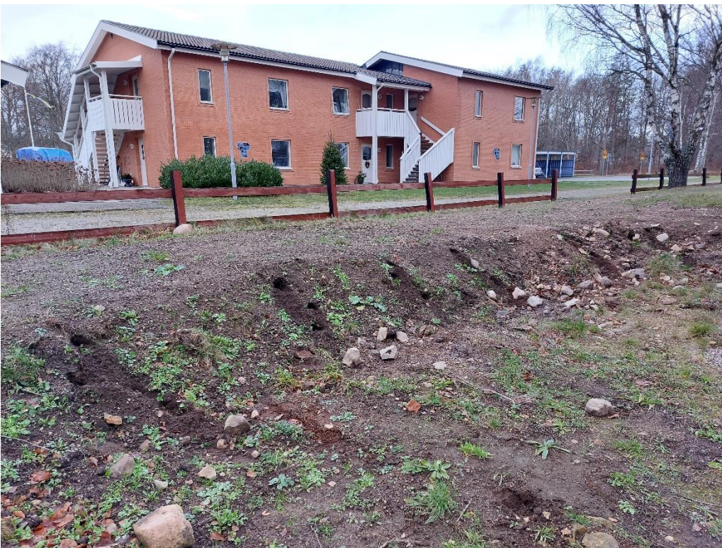
Figur 3. Schaktets södra schaktvägg. Lokalisering för uttagna delprov syns som små hål i schaktväggen.
