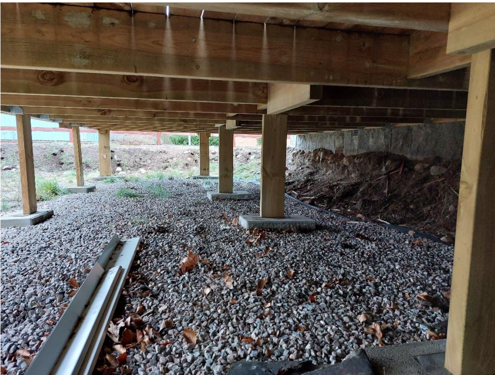
Figur 5. Fotat under altan från öster. Norra schaktväggen vid husväggen syns till höger i bild.
