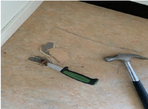
Bild 2. Dubbla lager ytskikt (linoleummatta på plastmatta).
