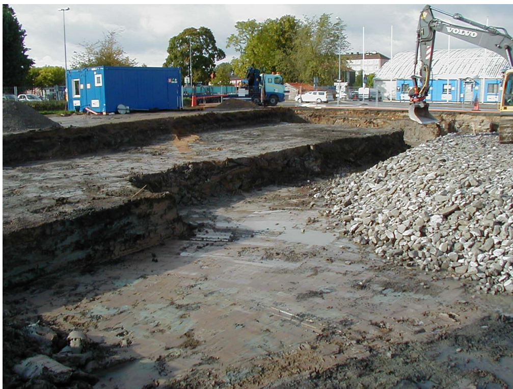
Figur 1. Kvarlämnade gröna massor i sydväst. Återfyllnad med bergkross syns till höger i bilden.
