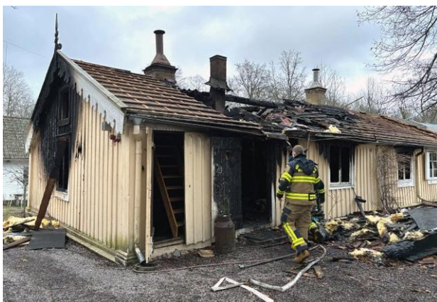
Figur 7: Annexet på världsarvet Skärva herrgård efter branden i januari 2025. Byggnaden uppfördes i slutet av 1700-talet och var sommarresidens åt skeppsbyggaren Fredrik Henrik af Chapman. Brandsorsaken är okänd. Foto: Sydöstran.
